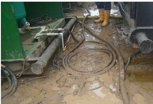
Fotografía 9 Fallas del sistema
