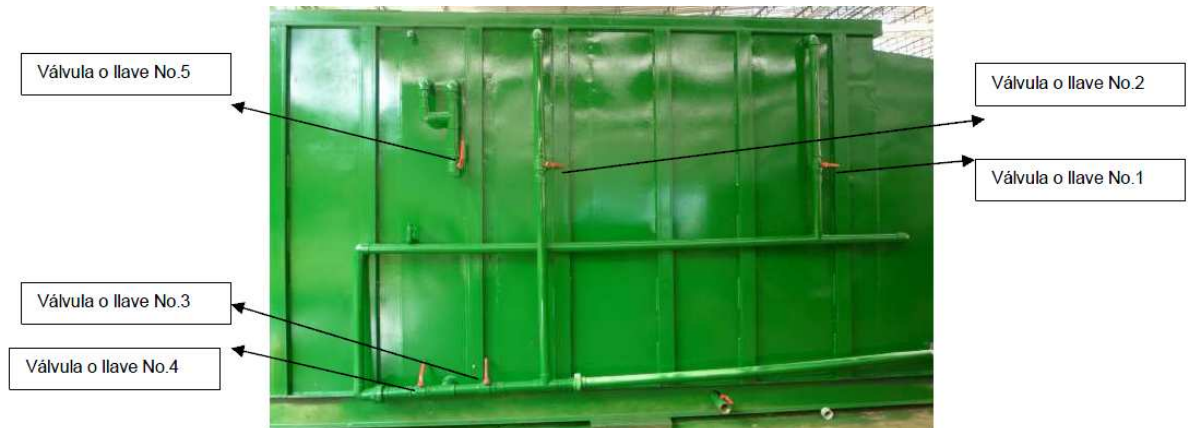
Fotografía 50 Planta de Tratamiento de Agua Potable
