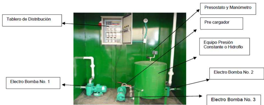
Fotografía 49 Tablero Operación Manual
