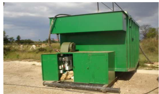
Fotografía 6 Vista Frontal PTAR
