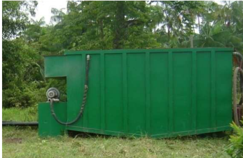
Fotografía 51 Vista Lateral Planta de Tratamiento de Agua Residual
