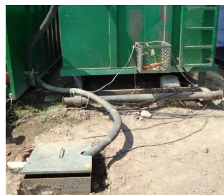
Fotografía 18 Caja de captación PTAR
