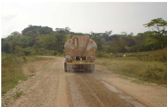
Fotografía 34 Vertimiento en vías
