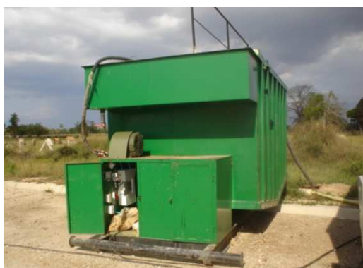
Fotografía 17 Instalación PTAR Red-Fox
