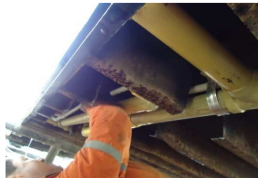
Fotografía 10 Control fugas del sistema
