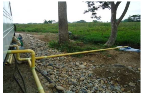
Fotografía 22 Conducción aguas grises
