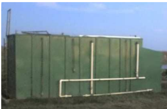
Fotografía 15 Planta de tratamiento de agua potable
