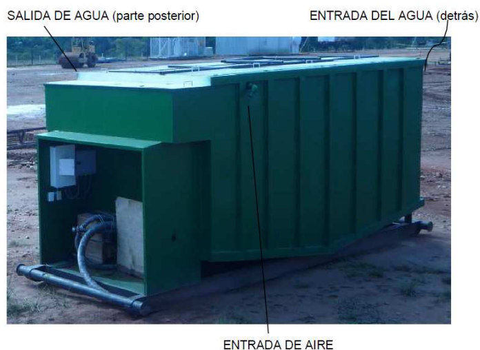
Fotografía 52 Vista Frontal Planta de Tratamiento de Agua Residual
