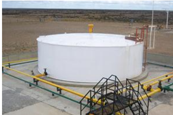
Figura 5. Tanques de almacenamiento.
