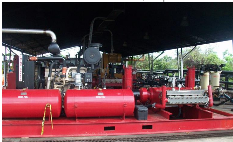
Figura 10. Unidad de Bombeo Hidráulico. Bomba Quíntuplex.
