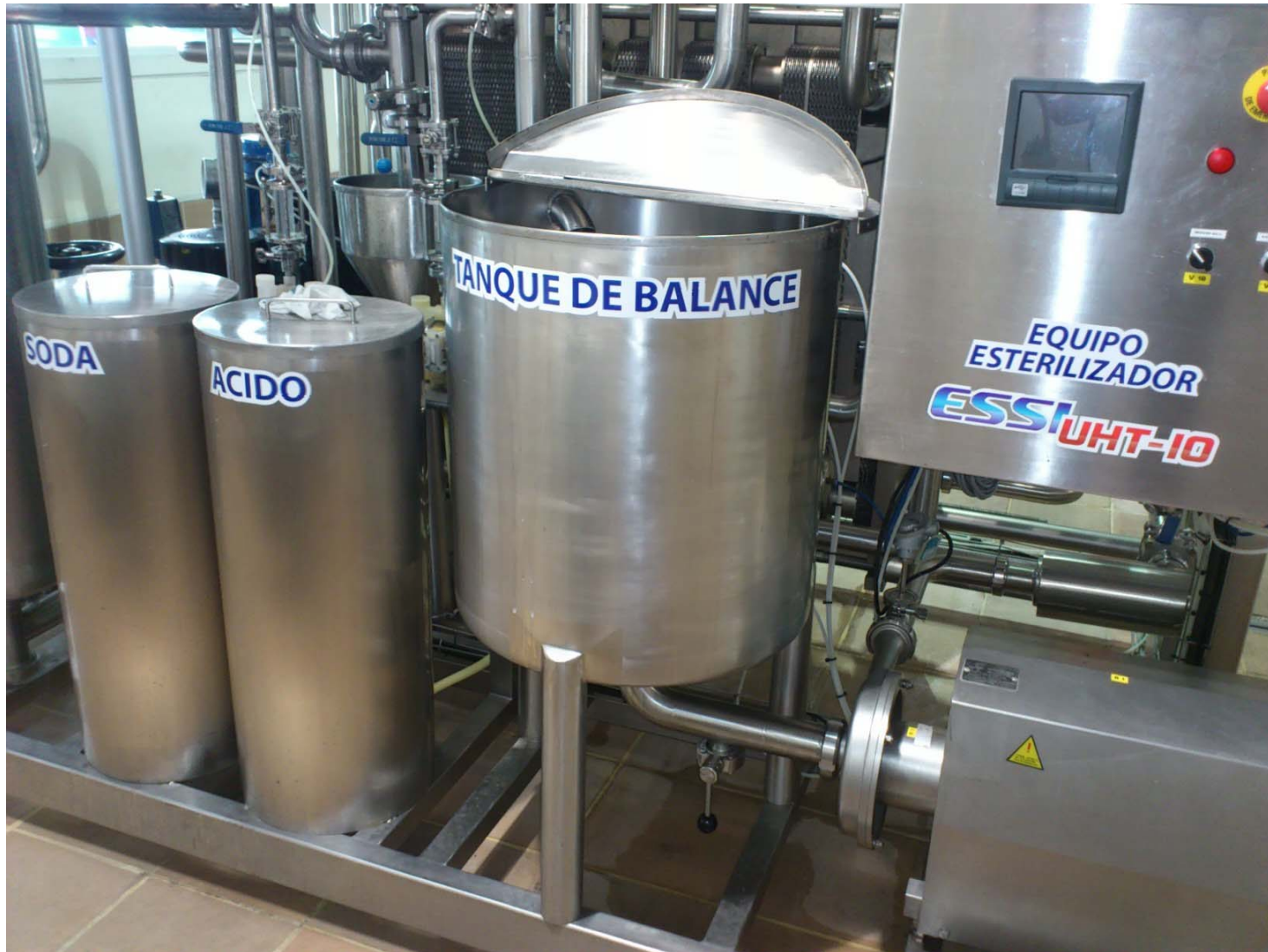
Anexo P. Esterilizador a placas ESSI UHT-10 instalado en Lechesan S.A.
