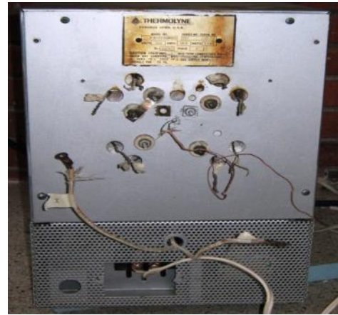
PRESENCIA DE OXIDO CARA POSTERIOR
