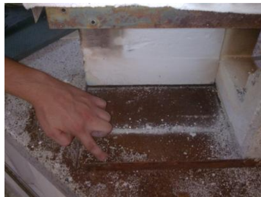
PRESENCIA DE OXIDO TAPA LATERAL DERECHA
