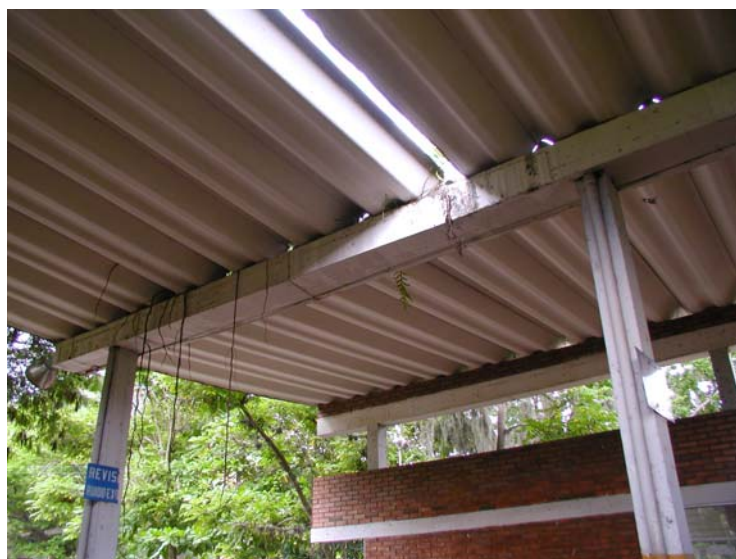
Fotografía 8. Techo actual del Centro en el área de las pistas.
