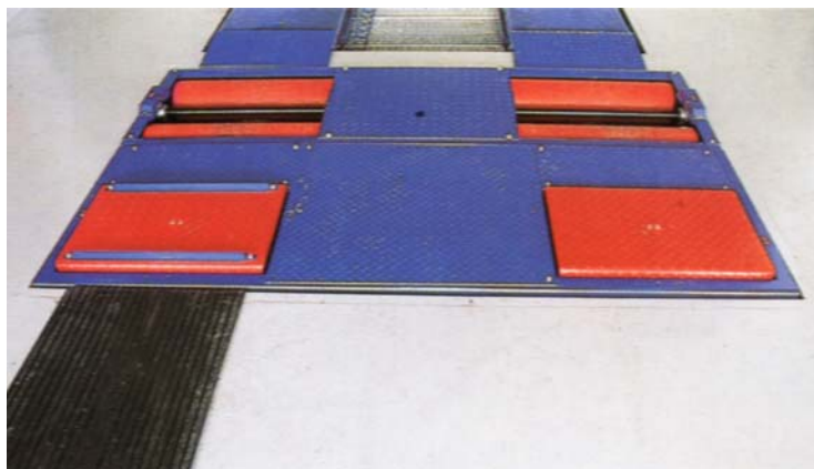
Figura 65. Detalle de alineador al paso, banco de prueba de suspensión y frenómetro, montados a ras de piso.
