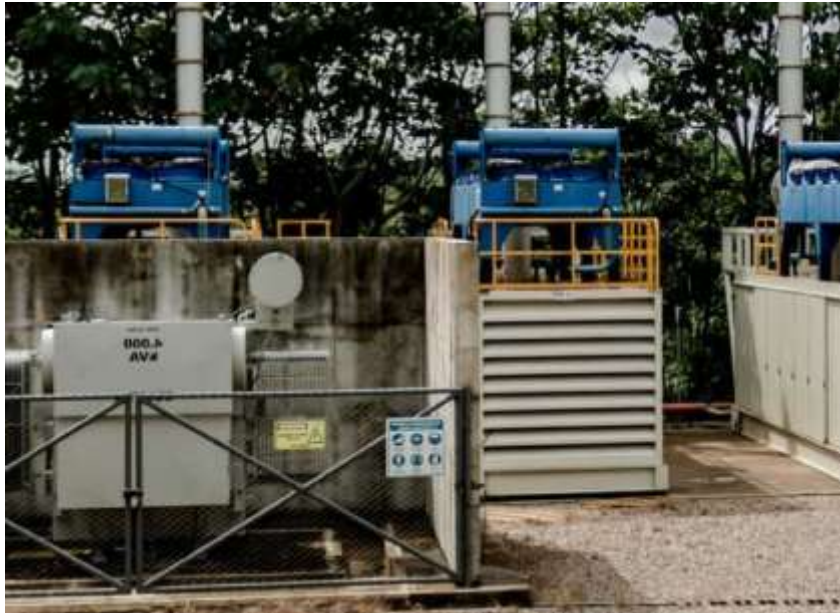
Figura 2. Plantas de generación. Adaptado de http://copower.com.co
