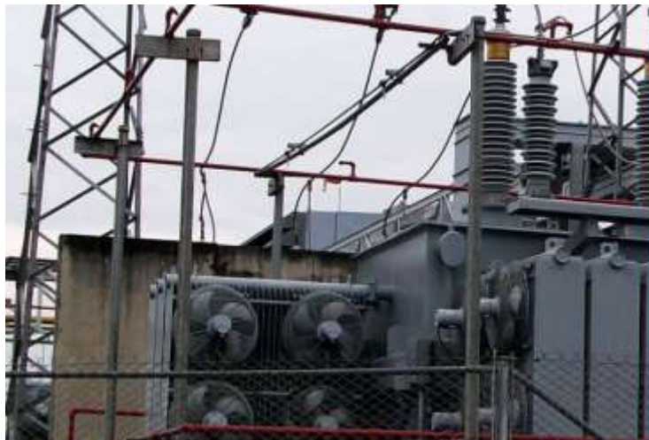
Figura 4. Transformador de Campo. Adaptado de http://copower.com.co/
