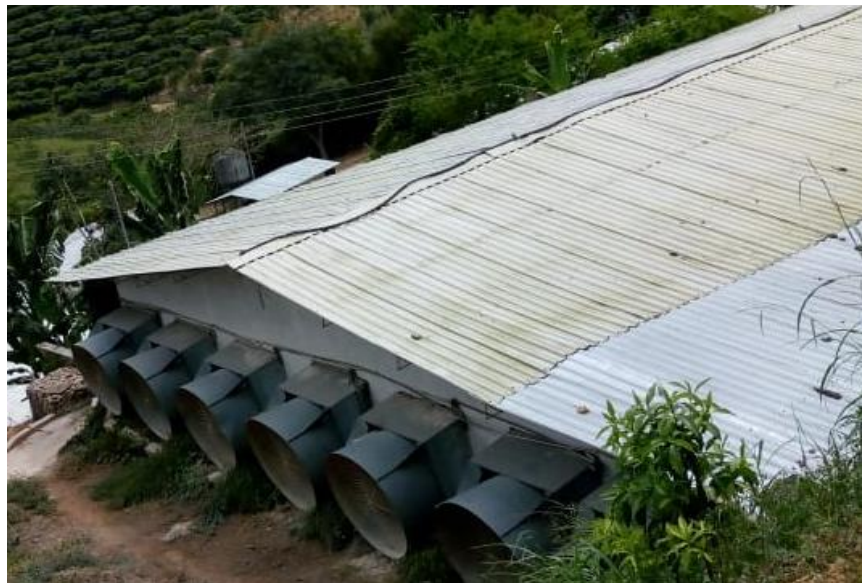
Figura 9. Distribución de los ventiladores al exterior del galpón
