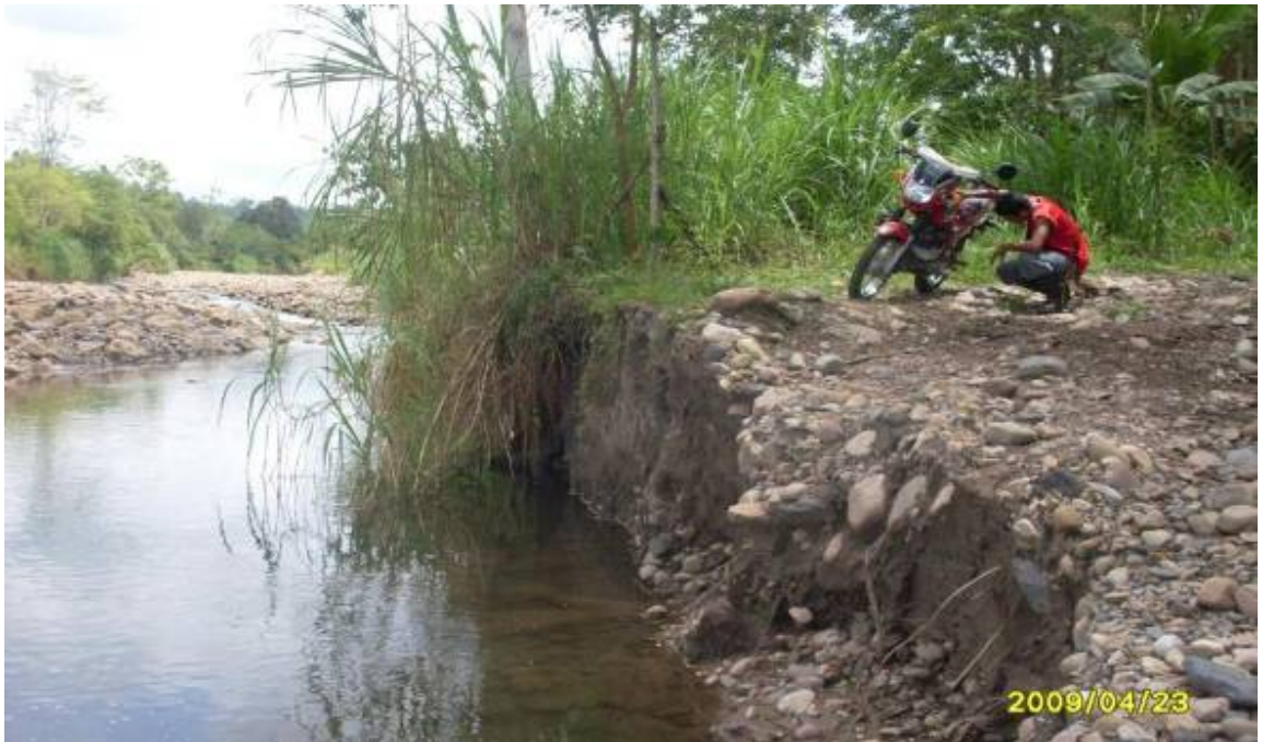
Figura 26. Detalle de la erosión lateral de los cauces
