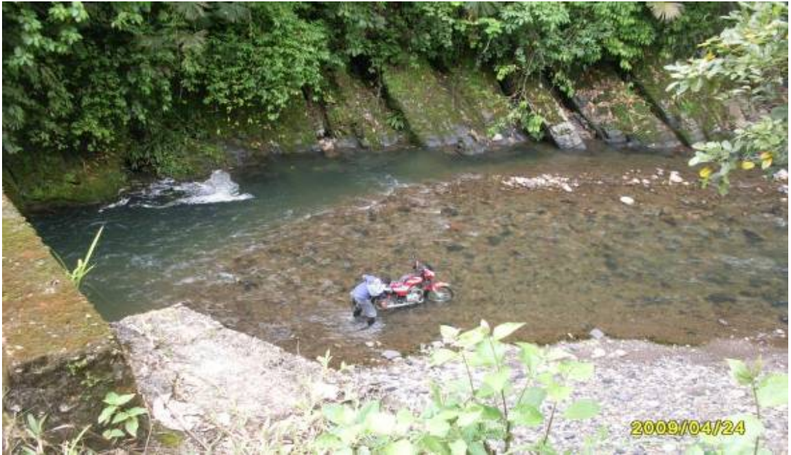
Figura 21 Erosión vertical, observada en el Rio Oponcito.
