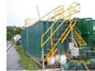
Tanque para almacenar agua residual industrial.
