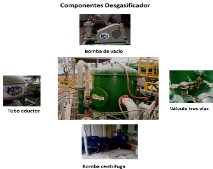
Figura 43. Componentes del desgasificador de vacío
