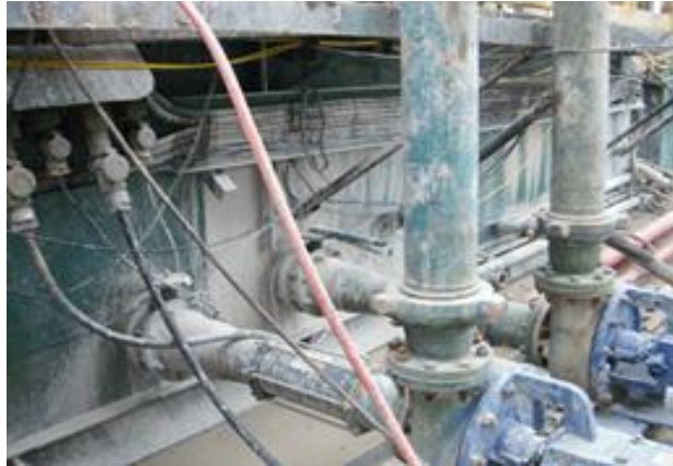
Figura 23. Tanques de retorno con succión de las bombas centrifugas
