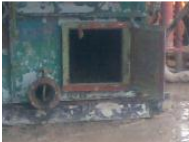
Figura 22. Compuerta exterior trampa de arena
