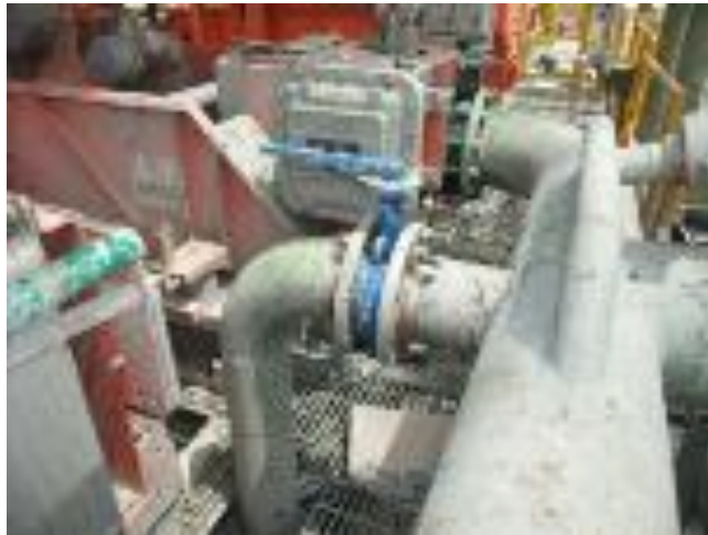
Figura 19. Línea de By Pass
