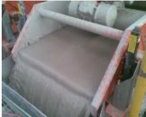
Figura 20. Desplazamiento zaranda apagada
