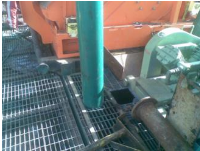
Figura 24. Descarga del desarcillador en la canaleta
