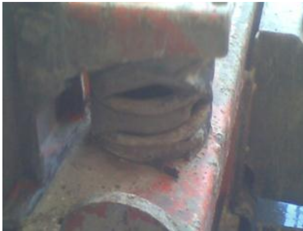
Figura 34. Resorte corroído y gomas
