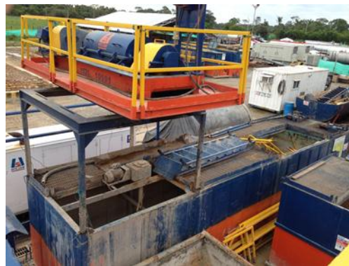
Figura 57. Unidad de Dewatering
