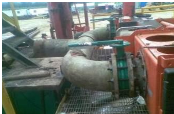
Figura 33. Manifold que alimenta las zarandas
