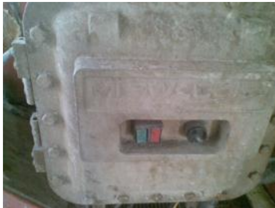
Figura 37. Caja eléctrica zaranda Swaco
