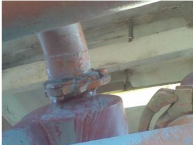
Figura 51. Cono con fuga de fluido
