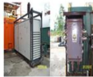
Generador y caja distribuidora.
