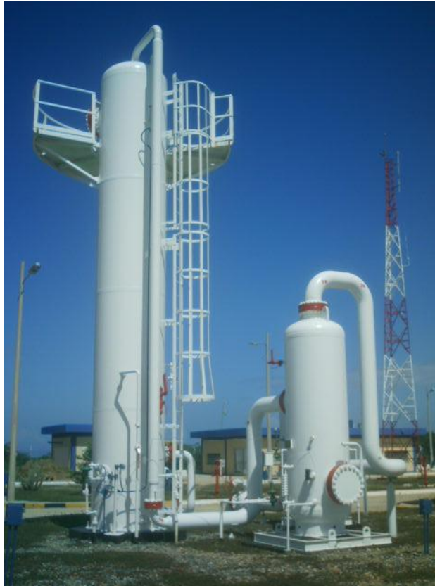
Figura 2. Torre contactora Estación Ballena
