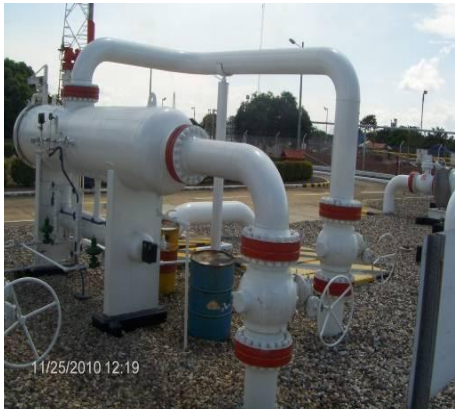
Figura 4. Filtro de sólidos horizontal Daniel
