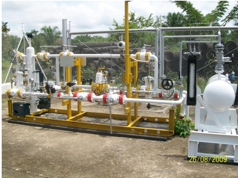
Figura 6. Estación de entrega de gas (City Gates)
