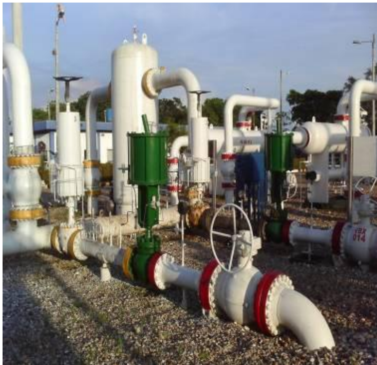
Figura 3. Elementos de regulación separación y filtración
