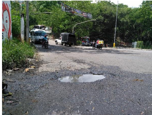
Figura 4. Estado de la malla vial.
