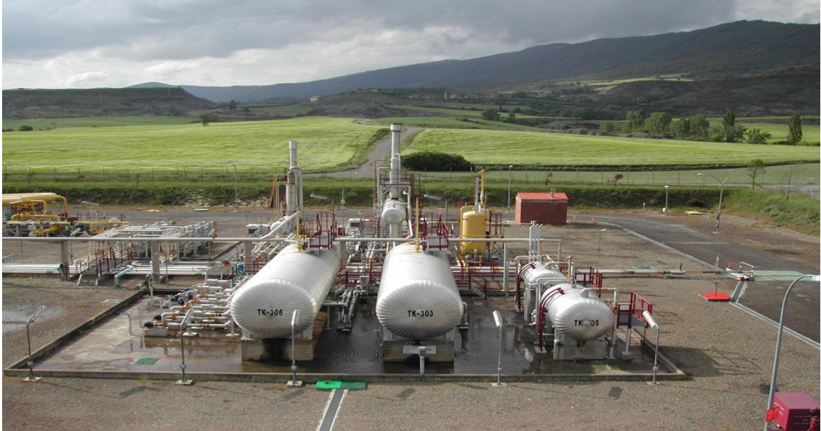
Figura 23. Instalaciones de almacenamiento subterráneo de gas
