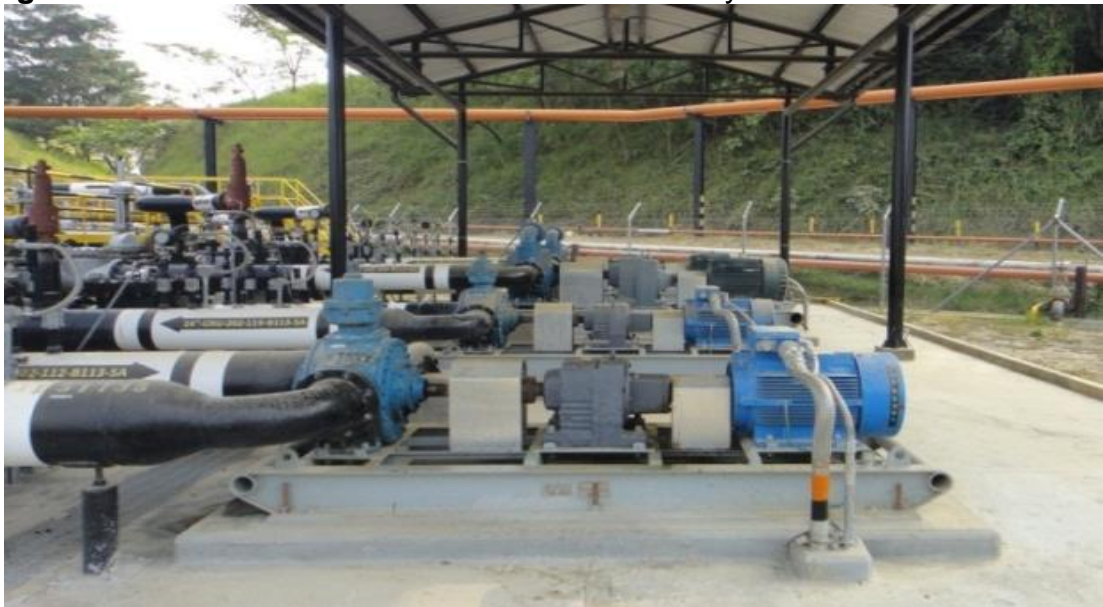
Figura 13. Bombas de transferencia P-1-2-003 A/B y P-1-2-005 A/B
