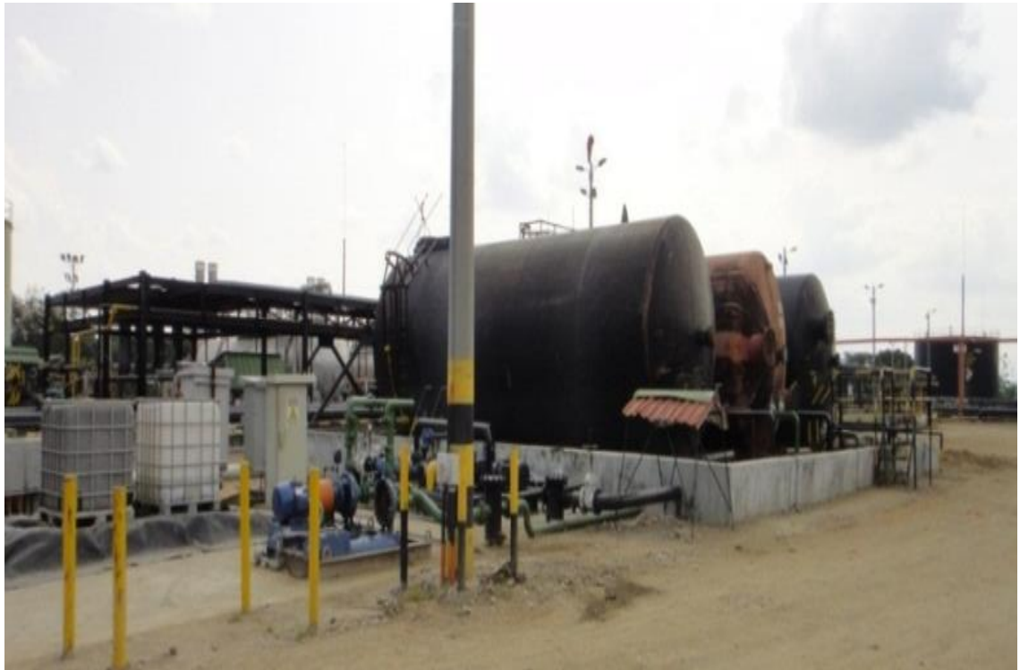
Figura 21. Planta de tratamiento de fluidos residuales
