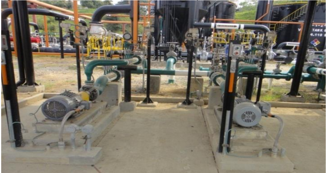
Figura 11. Bombas de coalescencia P-1-2-001 y P-1-2-002
