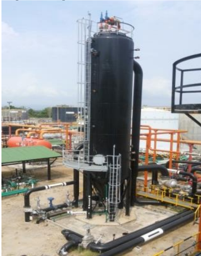
Figura 9. Fotografía del Surge Tank SE-MTB-001
