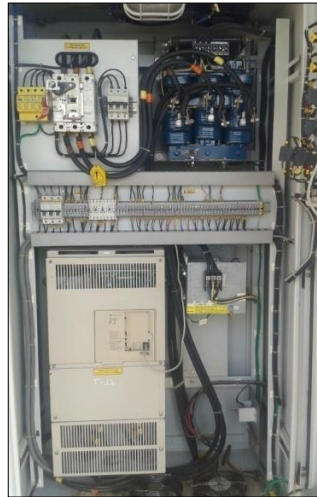
Figura 4. Caja de control del sistema PCP de YASKAWA.
