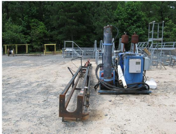
Figura 6. Equipo de superficie de un sistema de bombeo hidráulico- Tipo VSH2.
