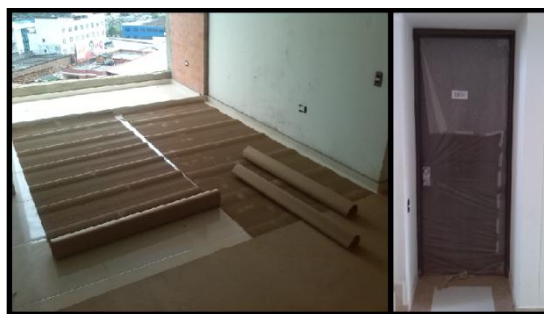
Figura 14. Puertas y pisos forrados.
