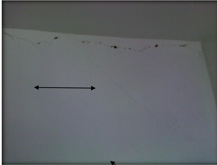
Fisuras en el sentido de la flechas
