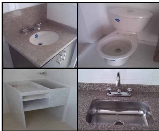
Figura 17. Algunos aparatos sanitarios.
