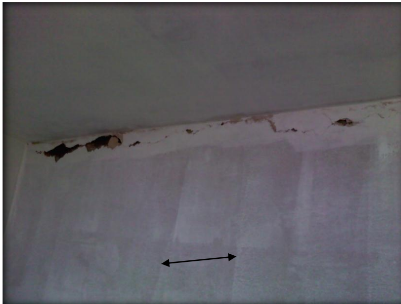
Fisuras en el sentido de la flechas
