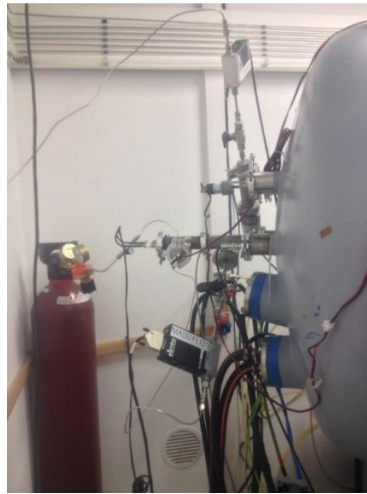
Figura 26. Vista posterior de la cámara, conexiones de las líneas de gases y refrigeración
