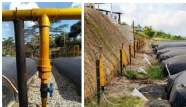
Figura 5. Filtros de H 2 S a la salida de biogás de los biodigestores
