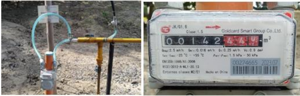
Figura 31. Contador de gas instalado a la salida de gas de los biodigestores
