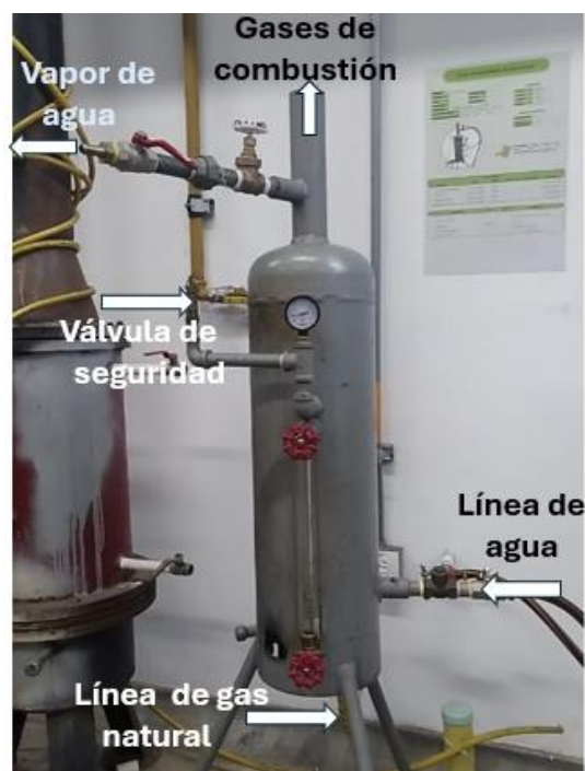
Figura 6. Evaporador del laboratorio de sistemas térmicos
