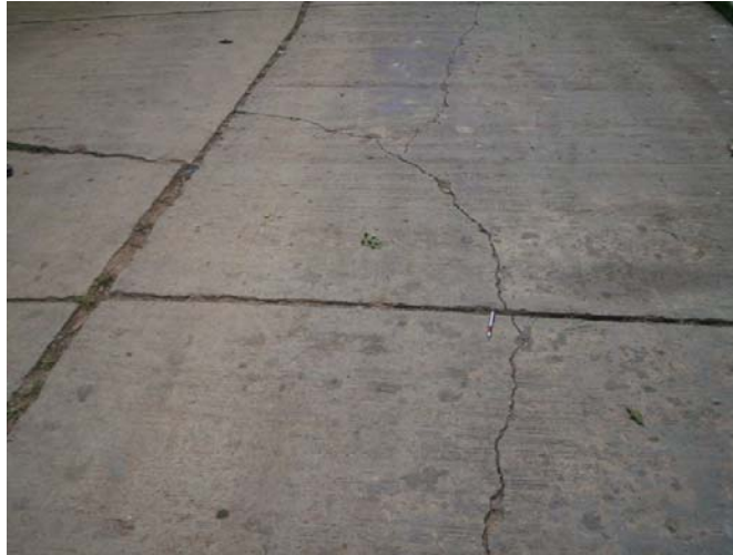
Figura 25. Grietas Longitudinales En Pavimento Rígido.
