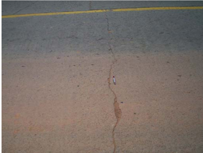
Figura 9. Grieta Transversal En Pavimento Flexible.
