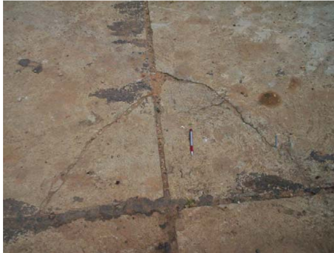
Figura 24. Grietas de Esquina.
