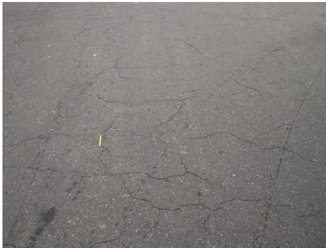
Figura 12. Fisura en Bloque.
