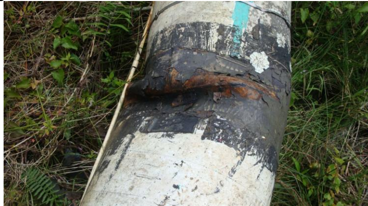
Figura 24. Arruga de la tubería de 22" sobre la soldadura.
