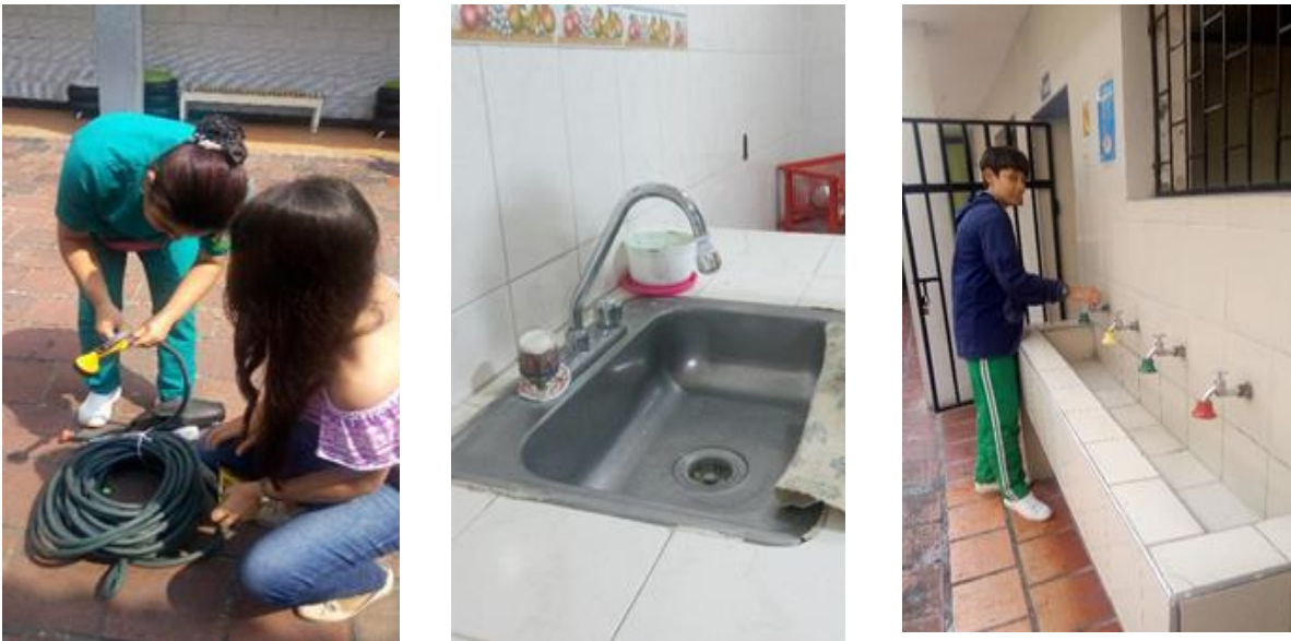
Figura 30. Instalación de boquillas ahorradoras de agua
