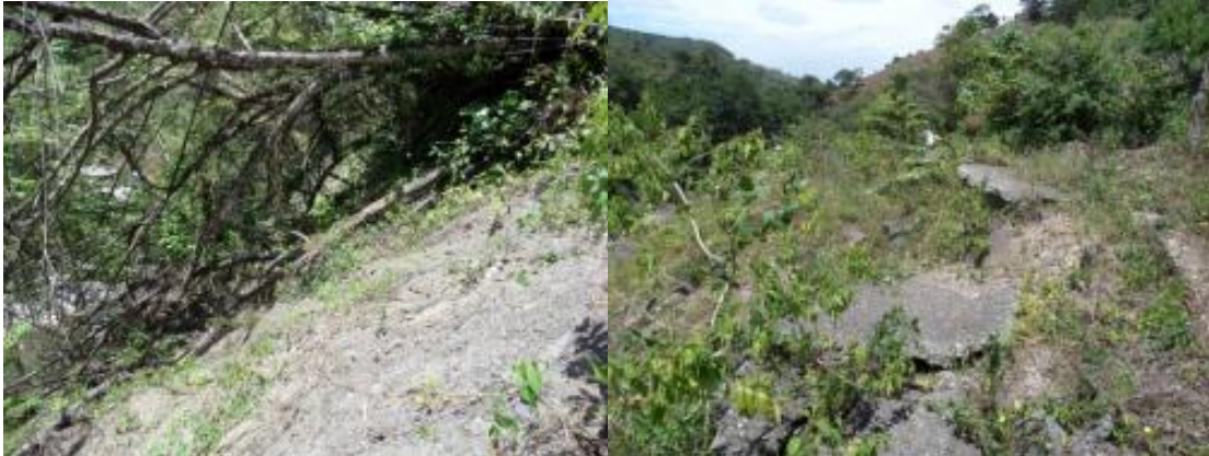
Figura 18. Árboles inclinados, Restos del pavimento.
