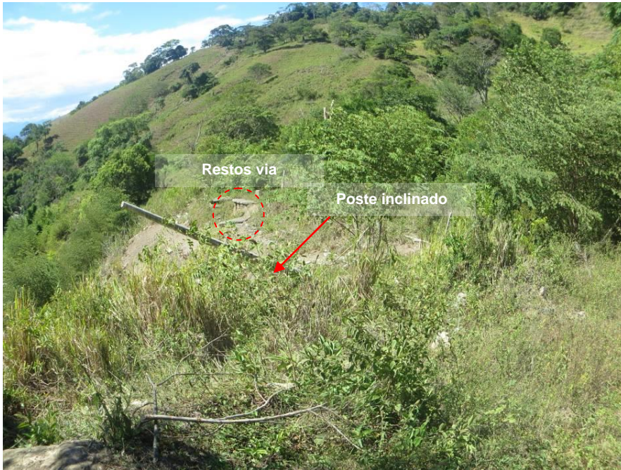
Figura 16. Zona superior del deslizamiento.
