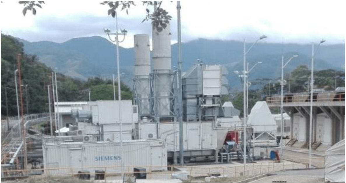
Figura 2 Vista de la estación de generación El porvenir – Páez
