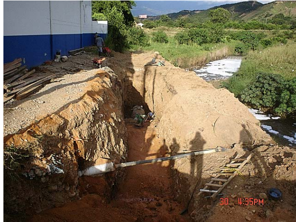
SECTOR METAL MARKET – ITALCOL SE SEÑALA EL POZO AL QUE SE CONECTA EL COLECTOR DE SALIDA
