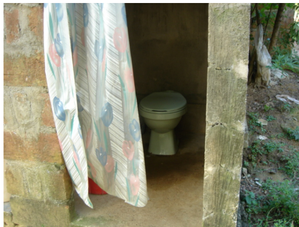
Batería sanitaria puesta en funcionamiento
