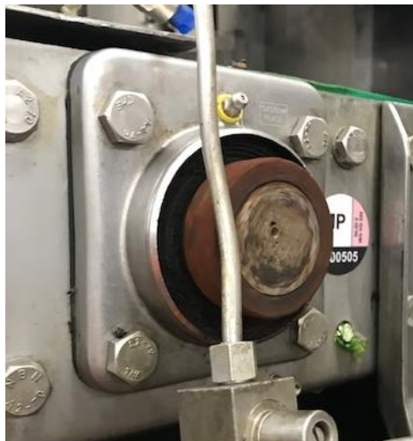
Figura 3. Condiciones anormales de operación de soporte de pared
