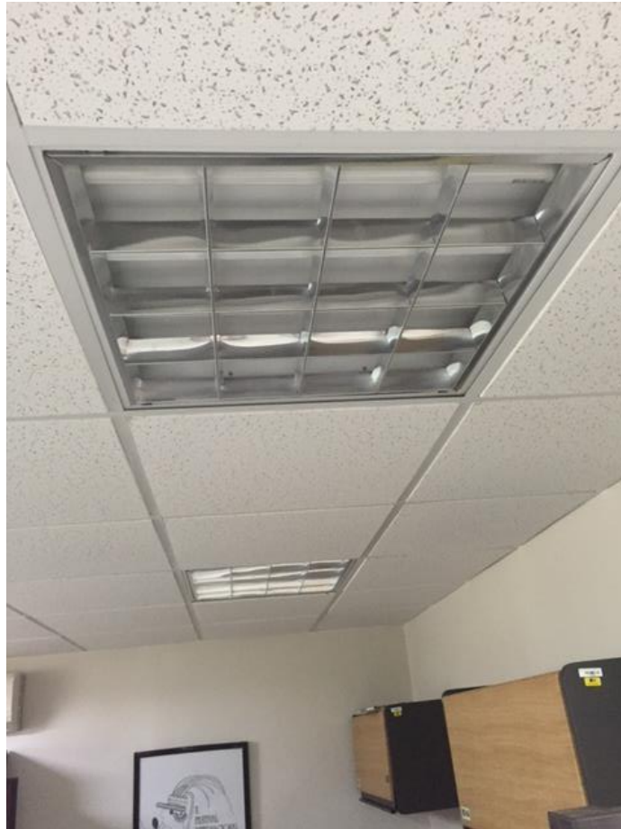
Figura 4 Iluminarias Relaciones Exteriores
