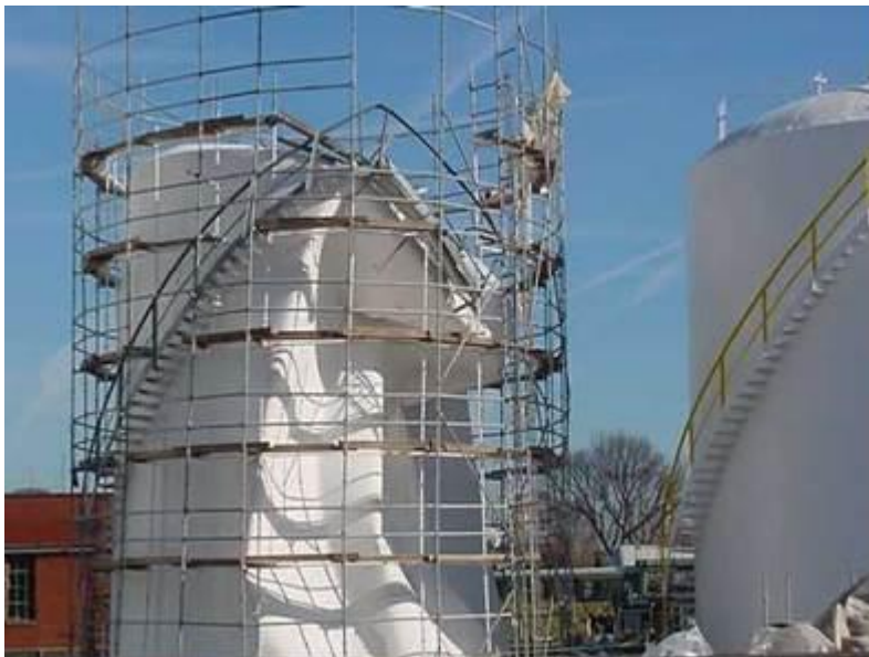
Figura 10. Implosión de un Tanque de almacenamiento
