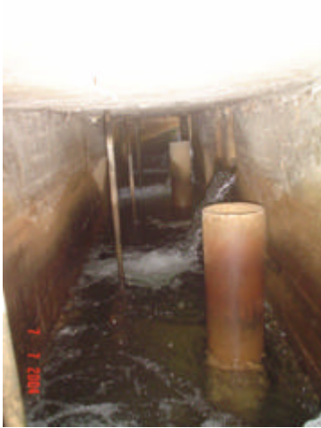
Fotografía 38. Compartimiento de agua sedimentada. Entrada a los filtros. Municipio de Curumaní.
