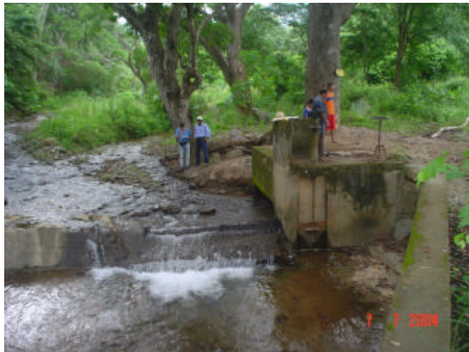
Fotografía 30. Bocatoma. Municipio de Curumaní.
