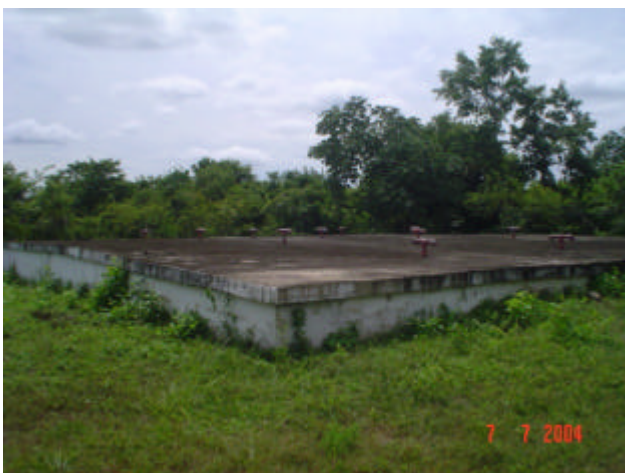
Fotografía 4. Tanque semienterrado de concreto. Municipio de Curumaní
