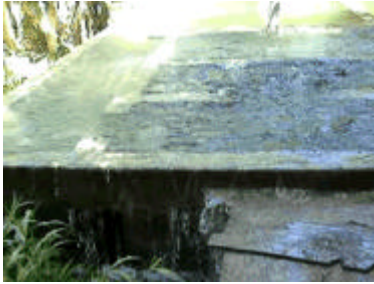
Fotografía 69. Desarenador del sistema vereda El Terror. Obsérvese el agua en exceso.
