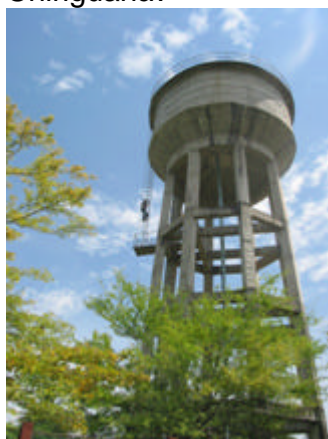
Fotografía 27. Tanque de concreto 1. Municipio de Chiriguaná.
