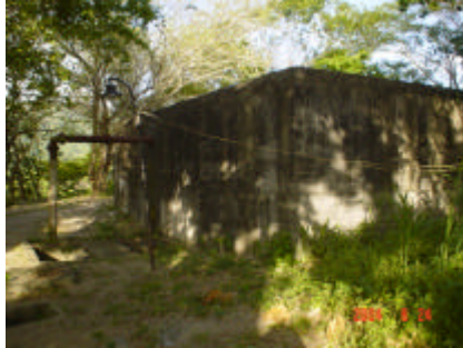
Fotografía 82. Tanque ubicado en la PTAP. Municipio de Pailitas.
