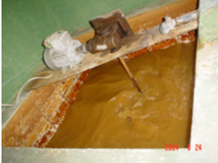
Fotografía 73. Mezclador mecánico. Municipio de Pailitas.
