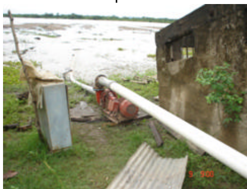
Fotografía 48. Bomba Siemens de 30Hp. Instalada fuera del cuarto de bombeo. Municipio de La Gloria.
