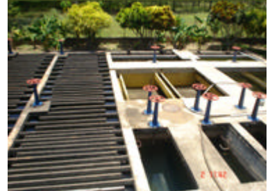
Fotografía 3. PTAP del municipio de Curumaní.
