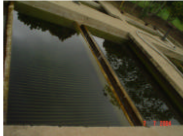
Fotografía 36. Sedimentador de alta tasa. Municipio de Curumaní.
