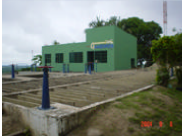
Fotografía 2. PTAP del municipio de Pailitas.
