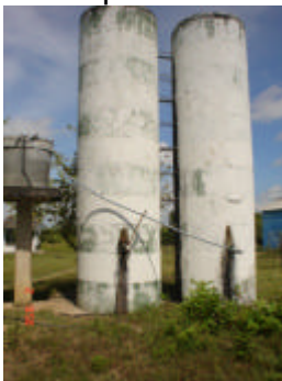
Fotografía 41. Tanques elevados. Municipio de Curumaní.
