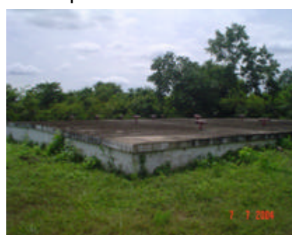
Fotografía 42. Tanque semienterrado. Municipio de Curumaní.
