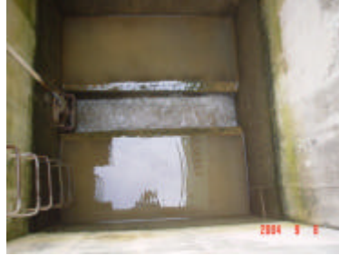
Fotografía 77. Filtro de lecho mixto. Municipio de Pailitas.
