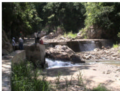
Fotografía 65. Bocanoma de la vereda El Terror.
