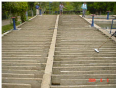
Fotografía 75. Floculadores. Municipio de Pailitas.
