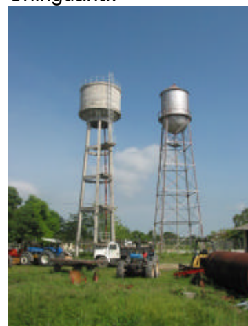
Fotografía 5. Tanques elevados de concreto y metal. Municipio de Chiriguana.
