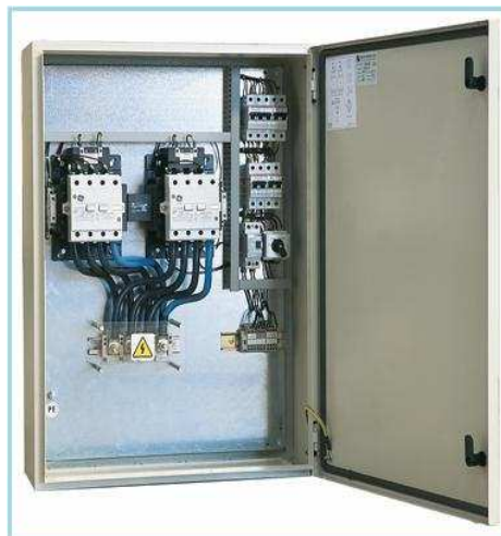
Fig 4. Caja de interruptores
