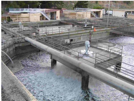
Figura 8. Planta de tratamiento biológico
