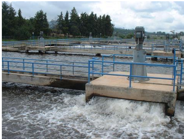
Figura 4. Aguas residuales urbanas
