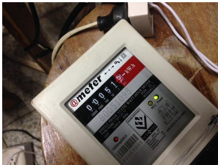
Figura 46. Medidor de energía eléctrica
