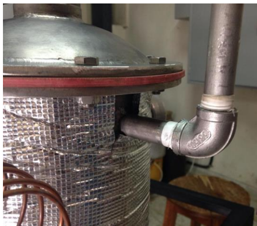
Figura 36. Ingreso de agua
