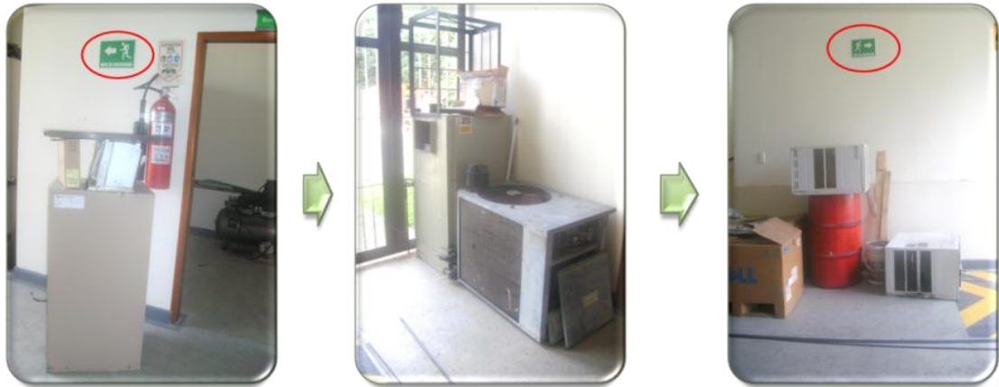
Ilustración 8. Inadecuada Disposición de AEE en áreas comunes – División de Mantenimiento Tecnológico
