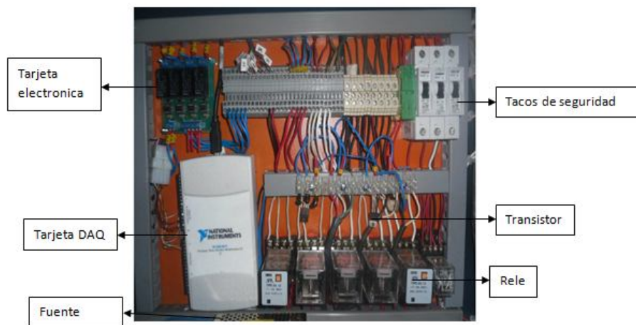
Figura 39. Unidad de control
