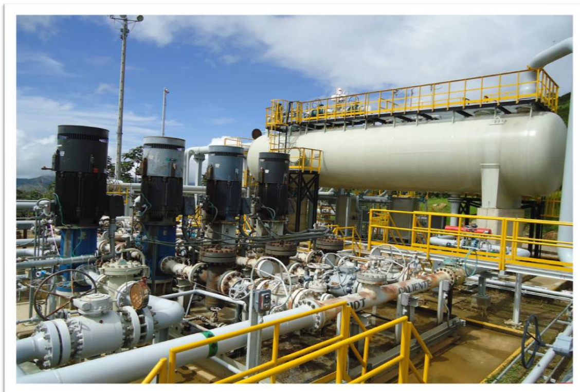
Fig. 6 Bombas de transferencia de crudo
