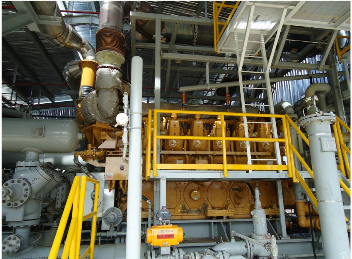
Fig. 7 Compresor “boosting” o de reforzamiento
