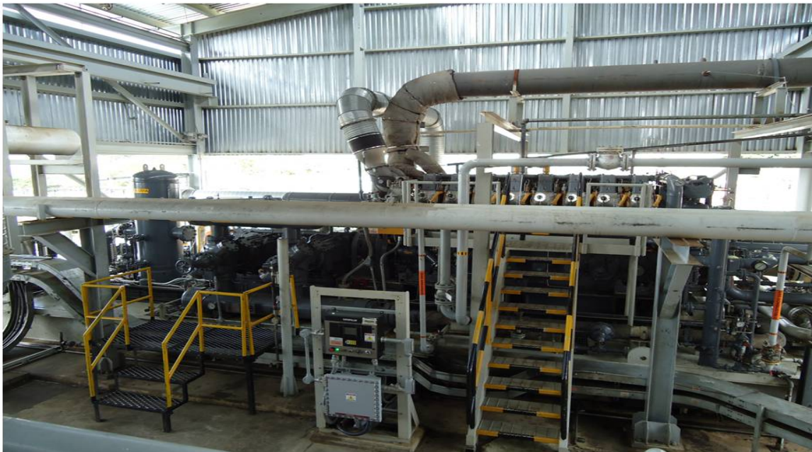
Fig. 8 Compresor de reinyección de gas
