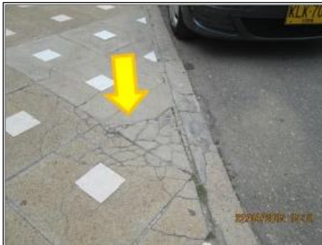
Figura 8. Estado de la vía
