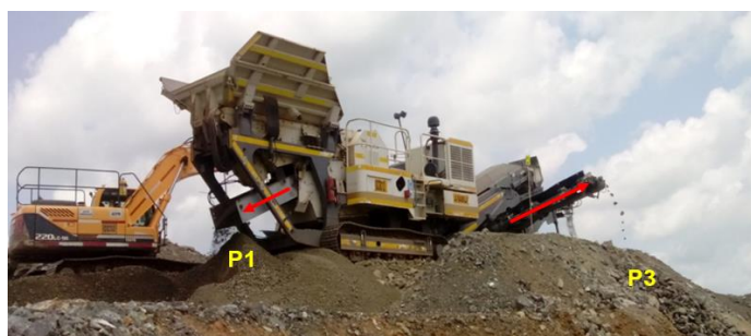
Figura 83. Salida de materiales de la trituradora. Se observa salida de Producto 1 y 3.
