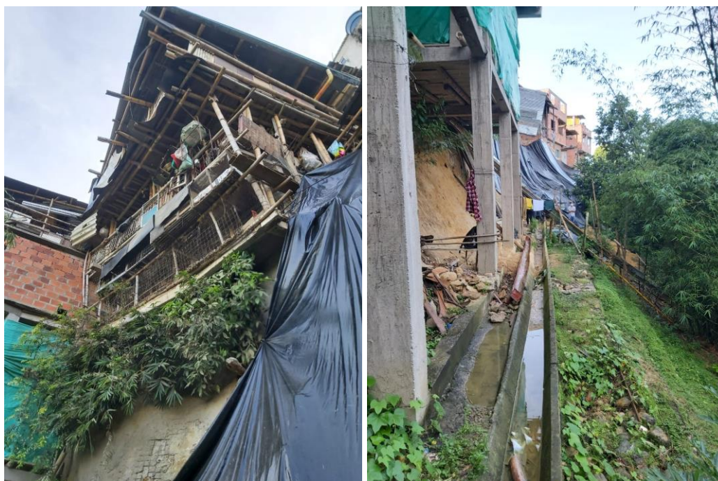
Ilustración 3: Viviendas ubicadas sobre la corona del talud
