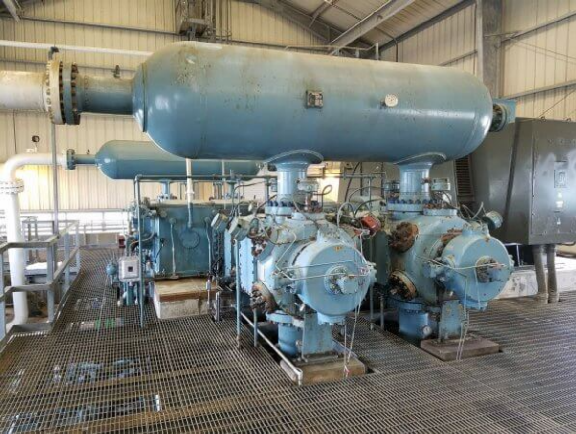
Figura 55. Compresor recíprocante tipo integral. Adaptada de Machinesaver. Disponible en: https://www.machinesaver.com/product/reciprocating-machines-pumps/
