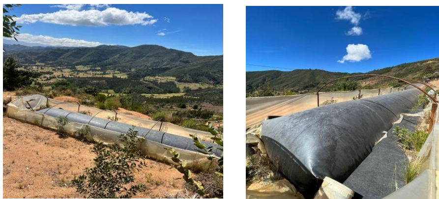
Figura 1 Biodigestor tubular ubicado en ECOCERD
