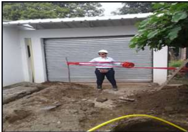
Figura 19. Señalización de peligro en zonas residenciales aledañas para prevenir accidentes por parte de los habitantes.
