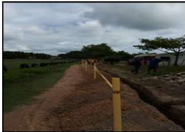
Figura 18. Señalización de la excavación y el personal de la obra con sus respectivos elementos de seguridad
