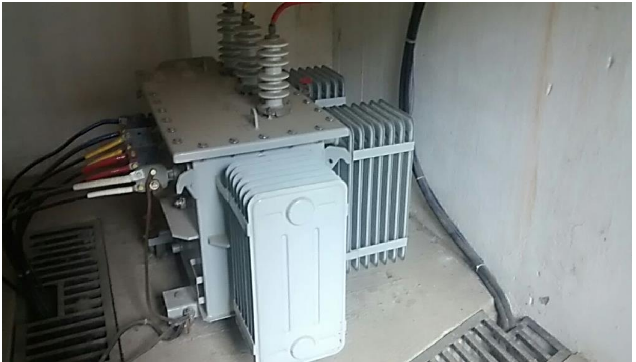
Figura 8. Transformador subestación edificio de Ingeniería Química
