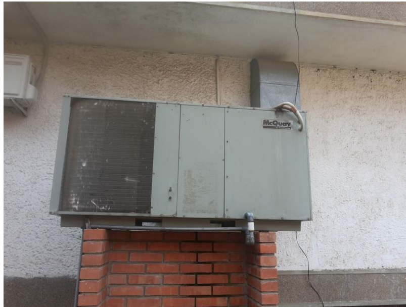
Figura 46. Unidad central Mc Quay
