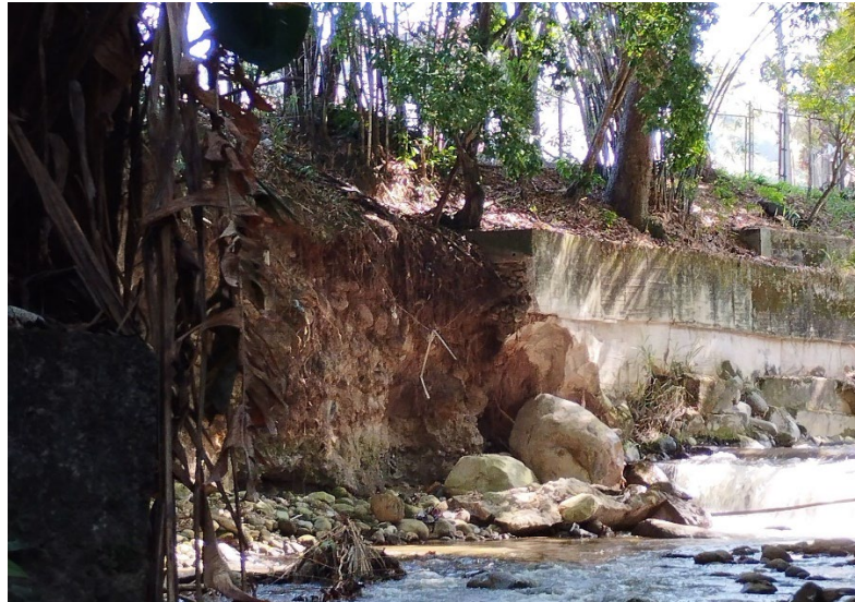
Foto 1 Socavación del Río Frío de los muros de contención– Fuente: Estudio CDMB
