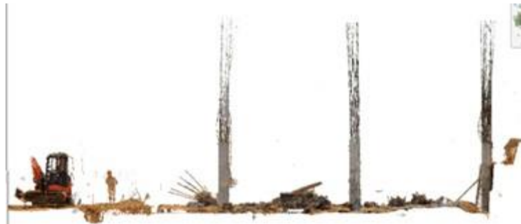
Figura 9. (a) Columnas en estudio del eje N (b) vistas desde el lateral izquierdo (c) del 09 de marzo de 2017.
