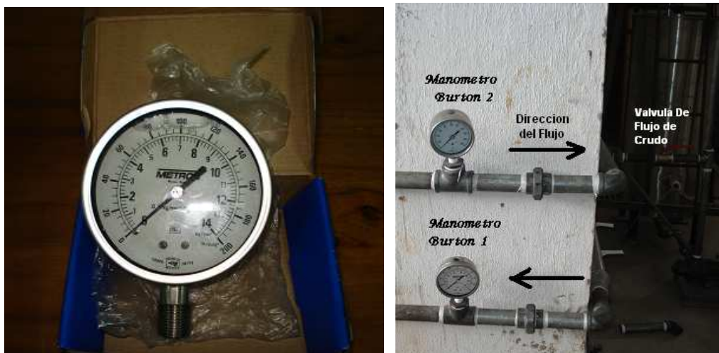
Figura 13. Sistema de Medición de Presión y Medidores
