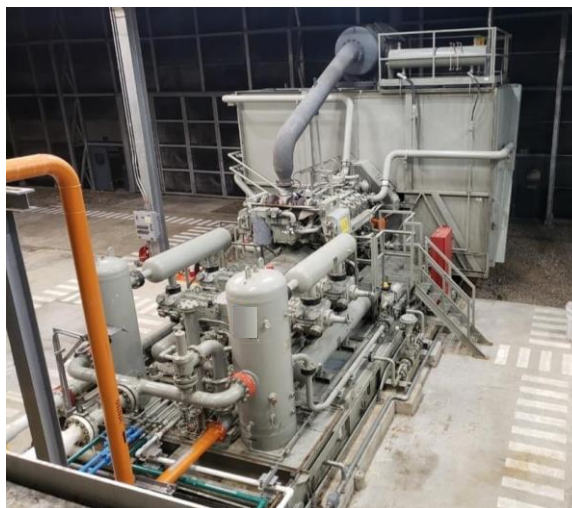
Figura 2. Equipo de compresión
