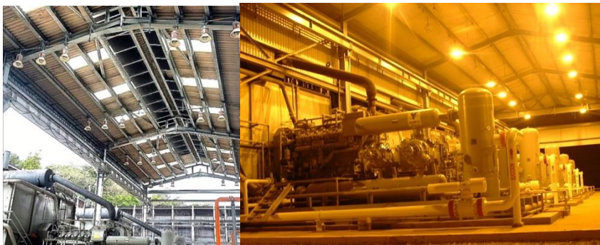
Figura 3. Sistema de Iluminación en Shelter de Compresores
