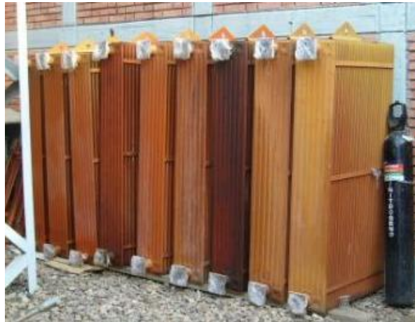
Figura 3.22: Vista de los radiadores del transformador Fuente: Autora del Proyecto
