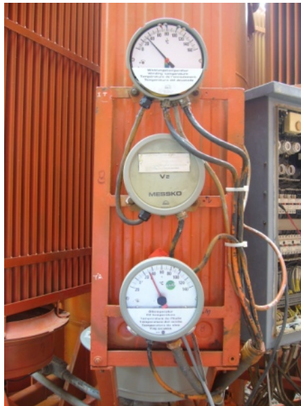
Figura 3.34: Diferentes elementos de medición y control Fuente: Autora del Proyecto
