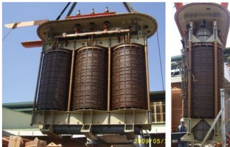
Figura 3.12: Devanados de un transformador trifásico Fuente: Autora del Proyecto
