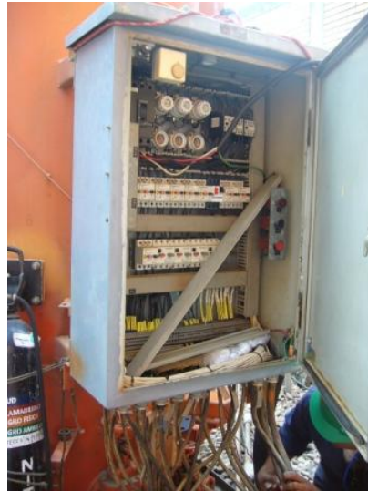
Figura 3.35: Vista del tablero del transformador Fuente: Autora del Proyecto
