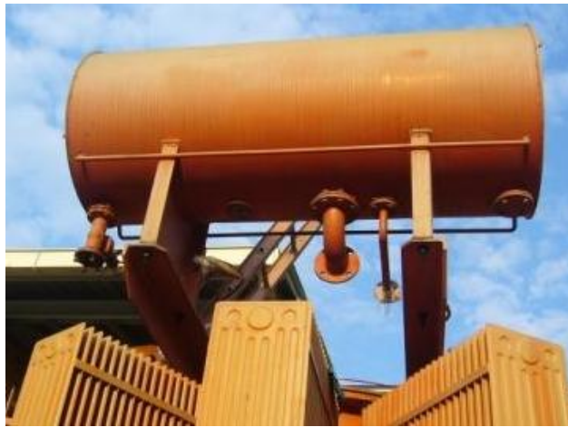
Figura 3.24: Vista del tanque de expansión Fuente: Autora del Proyecto
