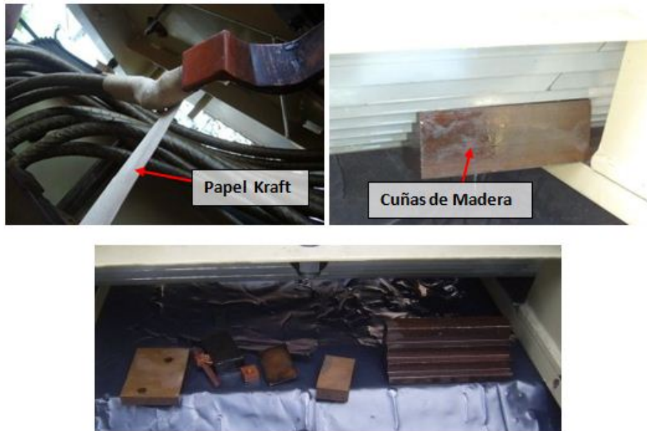
Figura 3.27: Piezas de Aislamiento Sólido Fuente: Autora del Proyecto
