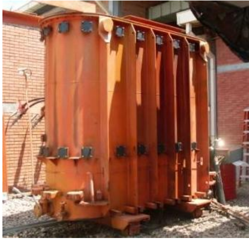
Figura 3.20: Vista del tanque Fuente: Autora del Proyecto
