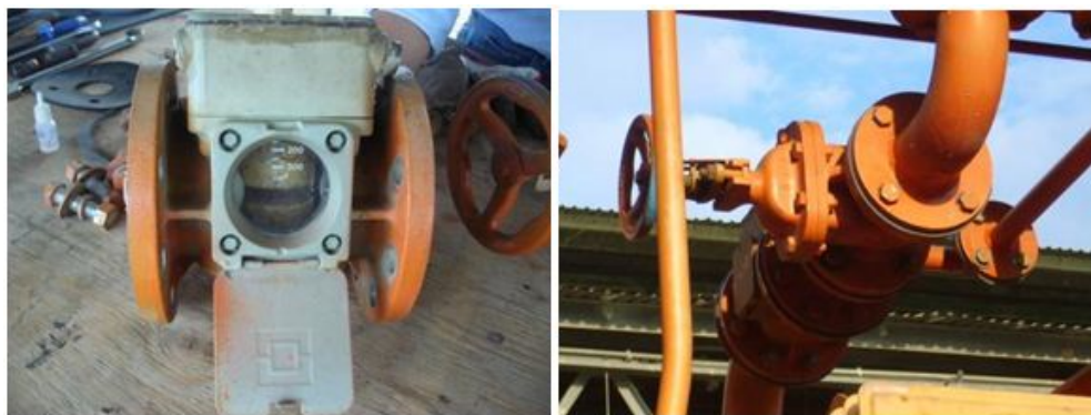
Figura 3.25: Vista externa del Relé y su ubicación Fuente: Autora del Proyecto
