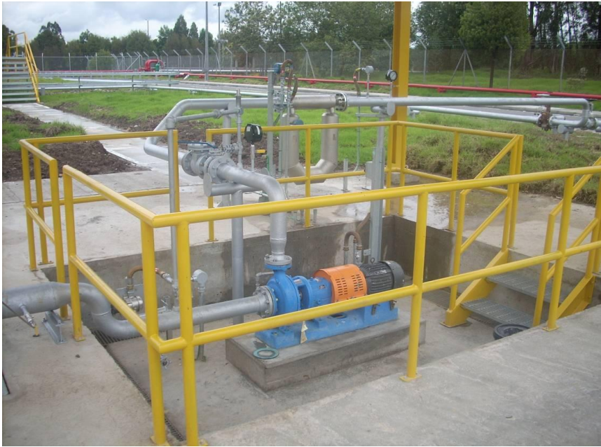
Fuente: Cargadero de Carrotanques- Estacion (Tocancipa).
