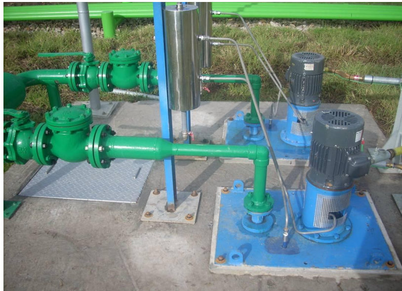
Fotografía 4. Sistema de Aguas Aceitosas
