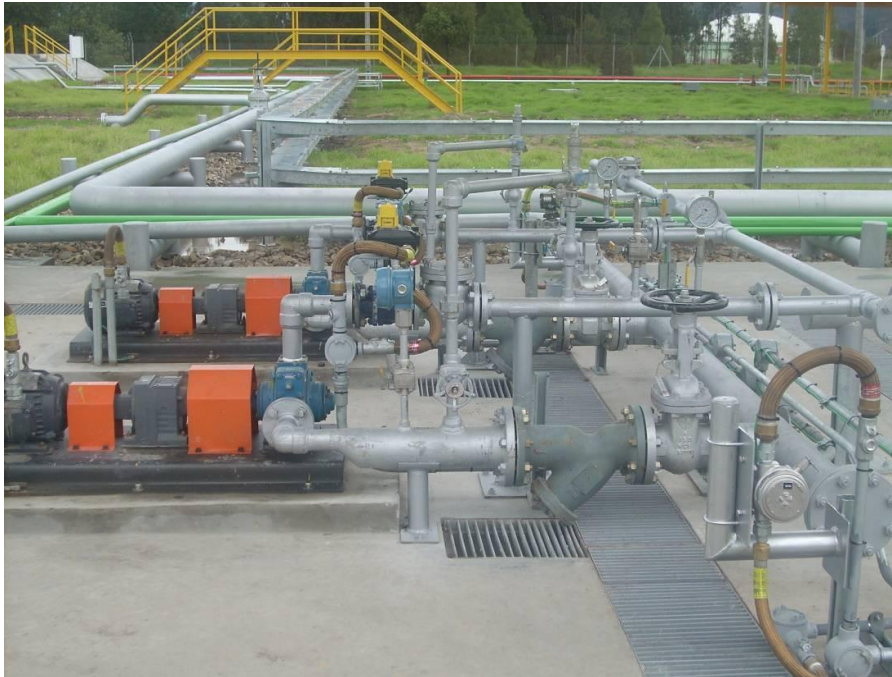
Fotografía 6. Bombas de Inyección de Crudo.
