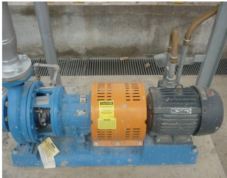
Fotografía 1. Bomba de descargue de Crudo
