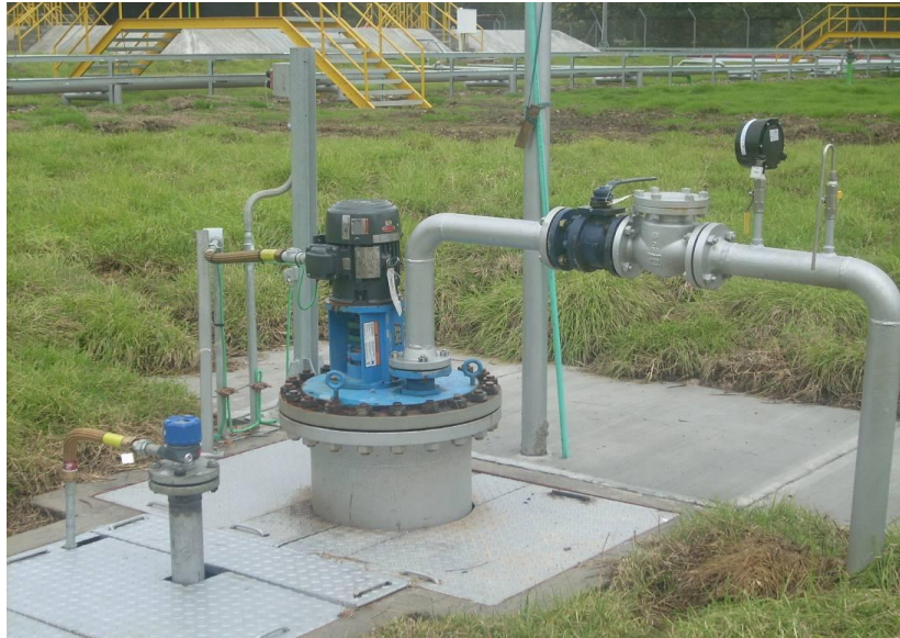
Fotografía 2. Bomba de Tanque de Sumidero.
