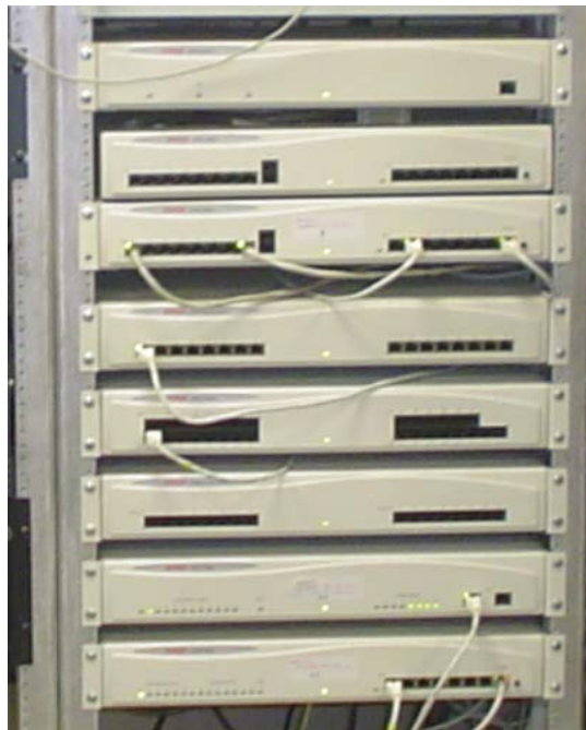
Figura 2-1. Montaje en rack de los módulos y servidores de la familia IP Office disponibles para el laboratorio. (Fuente: Fotografía tomada por el autor)
