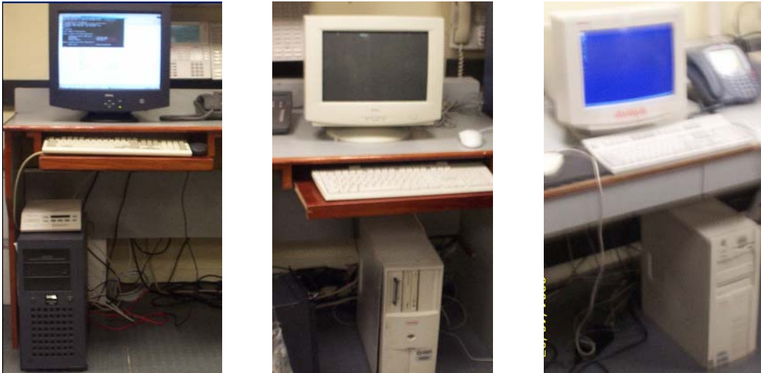
Figura 2-25. Servidores acondicionados (Fuente: Fotografía tomada por el autor)
