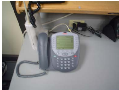
Figura 1-17. Teléfono Modelo 4620IP (Fuente: Fotografía tomada por el autor)
