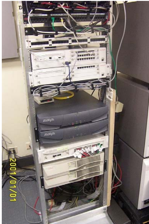
Figura 2-7. Ubicación de Servidores S8700, pueden apreciarse arriba el strip telefónico, y abajo el switch P333R y las UPS de cada servidor (Fuente: Fotografía tomada por el autor)
