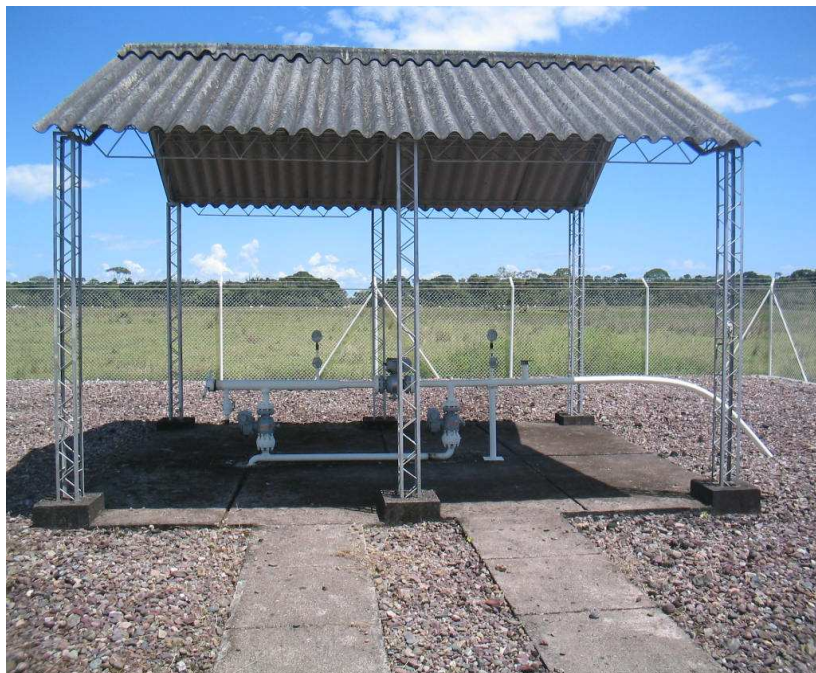
Figura 8. Trampa de despacho de raspadores, Ramal Cumaral-Restrepo
