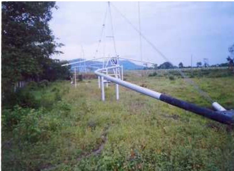
Figura 6. Cruce aéreo articulado ubicado en el Caño el Desquite.
