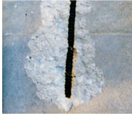
Figura 3. Efecto de la carbonatación en el refuerzo y el concreto. Tomado de [15].
