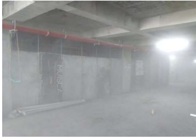
Figura 21. Ambientes peligrosos en la obra. Nota. Tomado de: INSUT SAS.
